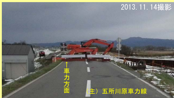
▲ 通行止の様子
